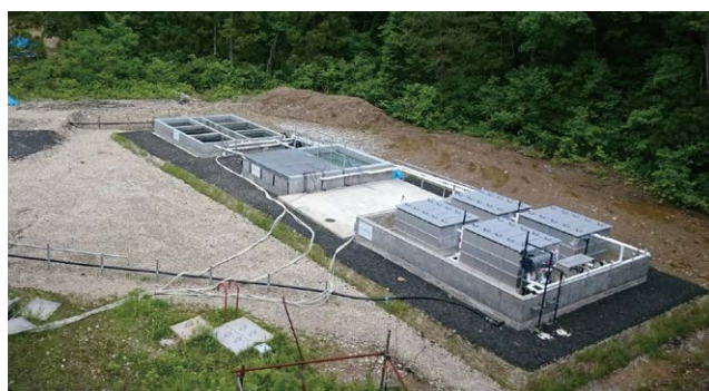
パイロットスケールテストプラント
